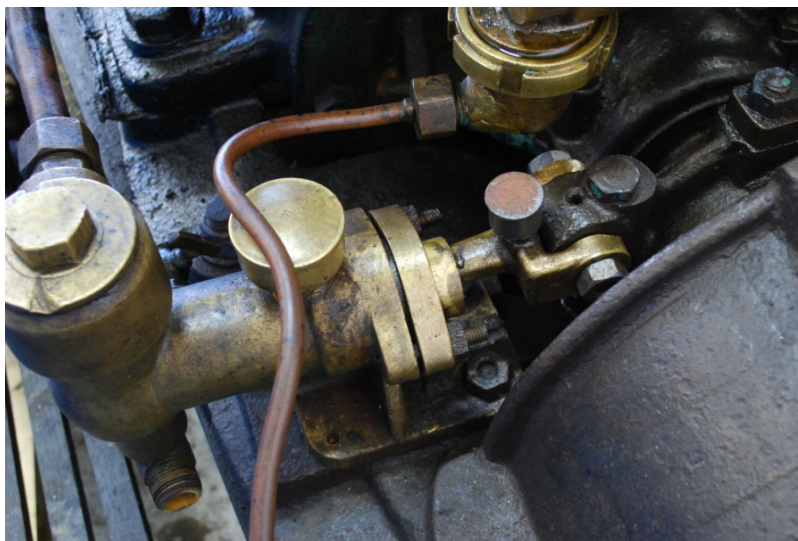
Pumpene er gjerne enkle konstruksjoner som er lette å utbedre/tette
