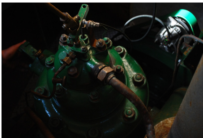
Det bør være mulig å legge hånden på kjølevannsrøret som kommer ut fra toppen, uten å brenne seg
